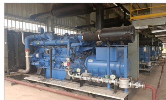
广东工程有限公司2台900KW发电机组项目
