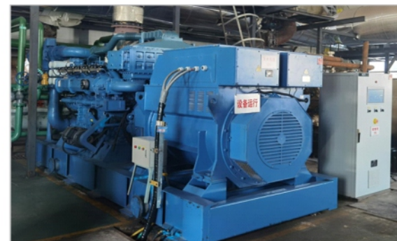
河南焦作煤矿低浓瓦斯600KW发电机组项目
