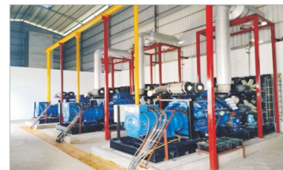
缅甸曼德勒3台800KW沼气机组发电项目
