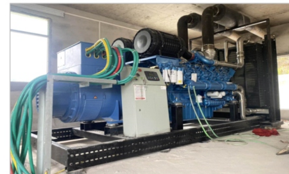
韶关工业厂房1台800KW发电机组项目
