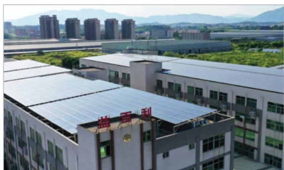
漳州佰佳益网络科技有限公司1.5MW光伏项目
