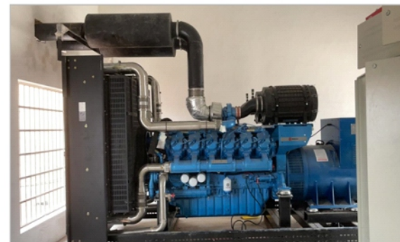
湖南牧业有限公司 2台680KW发电机组项目
